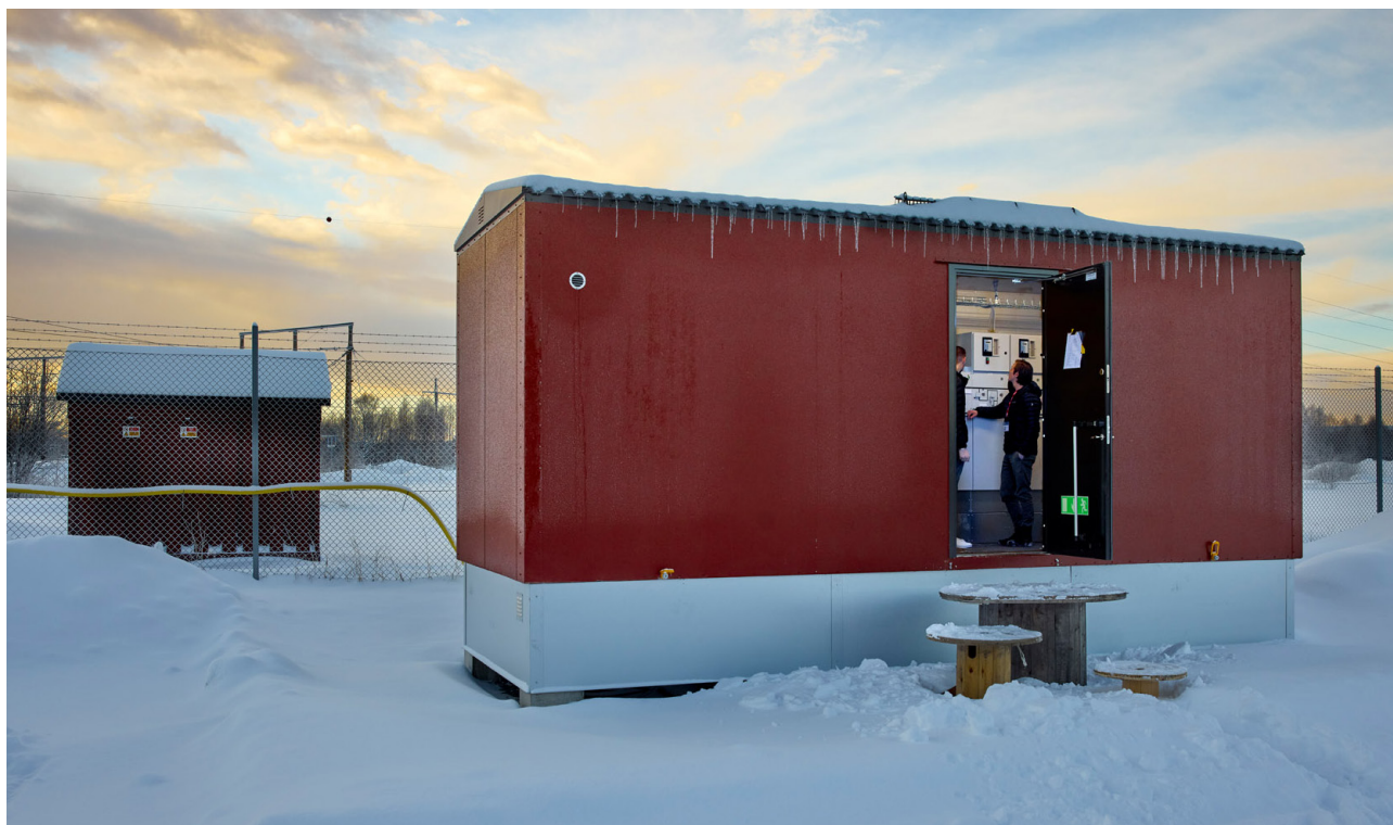
Teknikhus med mellanspänningsställverk och batteriutrustning från Harju Elektek. Fördelning från Boden Energi i bakgrunden.
