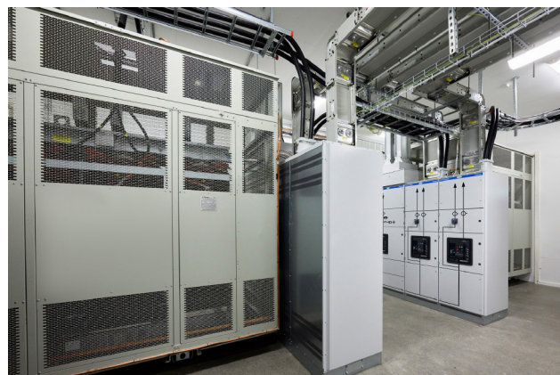
Ett av tre transformatorrum med två transformatorer och tillhörande lågspänningsställverk för ventilation och serverdrift.
